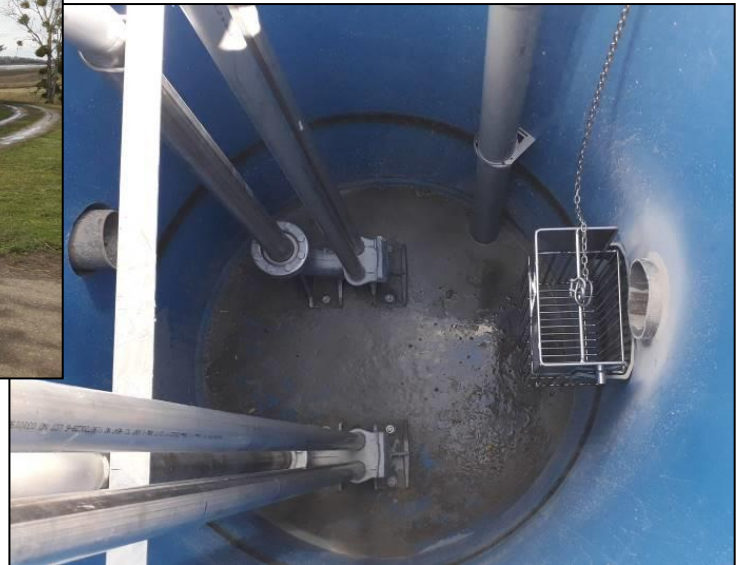
Figure 18 : Cuve d'un poste de pompage avant équipement (Réchicourt la Petite)
